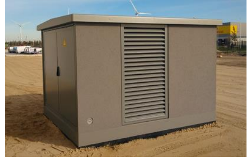
Figuur 9. Uiterlijk van de transformatorstations
