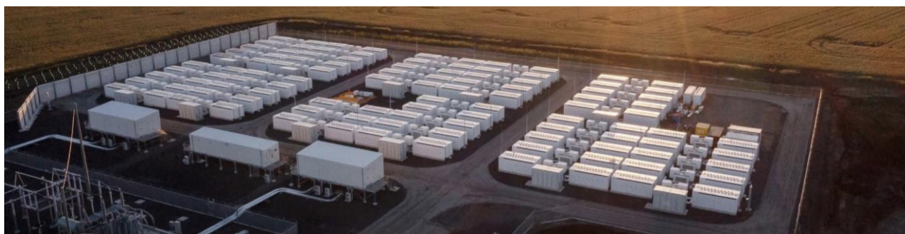
Figuur 1 Illustratie van de mogelijke opstelling van diverse componenten van een grootschalig batterijsysteem.
